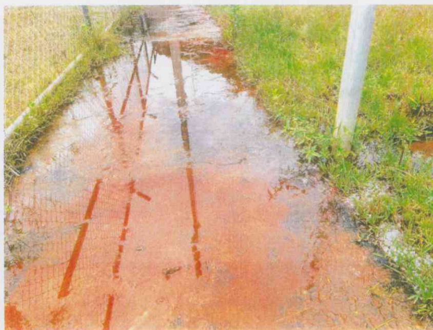
Figura 6 – Calçada do estádio alagada.
