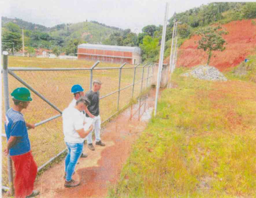
Figura 3 - Canaleta existente assoreada.
