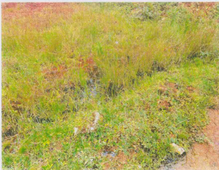
Figura 4 - Canaleta existente assoreada.
